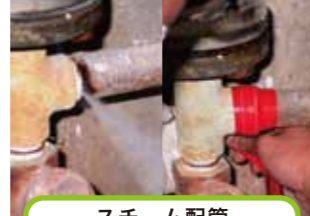
スチーム配管
